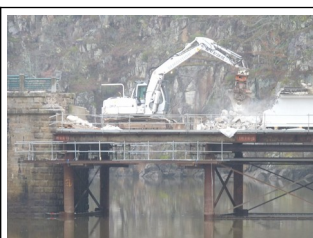
14-01-2021 Poursuite de la démolition du tablier avec pelle en action sur le platelage de l'étaie
